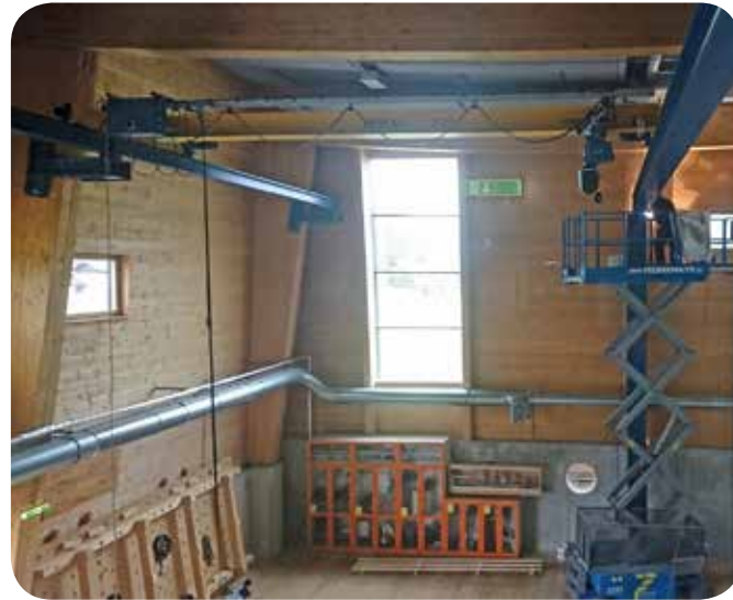
Der neue Deckenkran ist einsatzbereit
