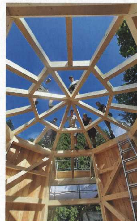
Schüler der Fachschule haben anlässlich ihrer Abschlussarbeit für das Sozialprojekt Badhaus in Leogang ein barrierefreies Spielhaus auf Stelzen gefertigt. Hier ein Einblick in die Dachstuhlkonstruktion. © Holztechnikum Kuchl, Alexander Schuster
